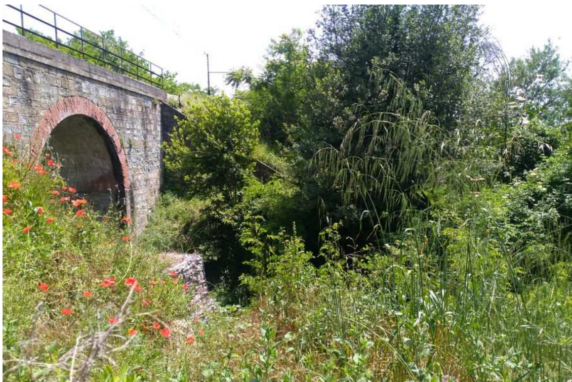
Passerella su Fosso del Burlazzo: situazione esistente
