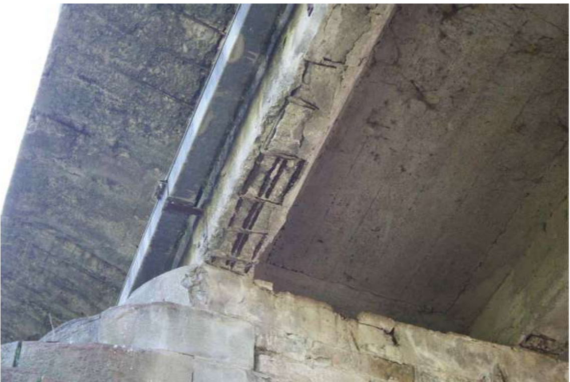
FOTO 13 - Impalcato lato monte - Particolare degrado
