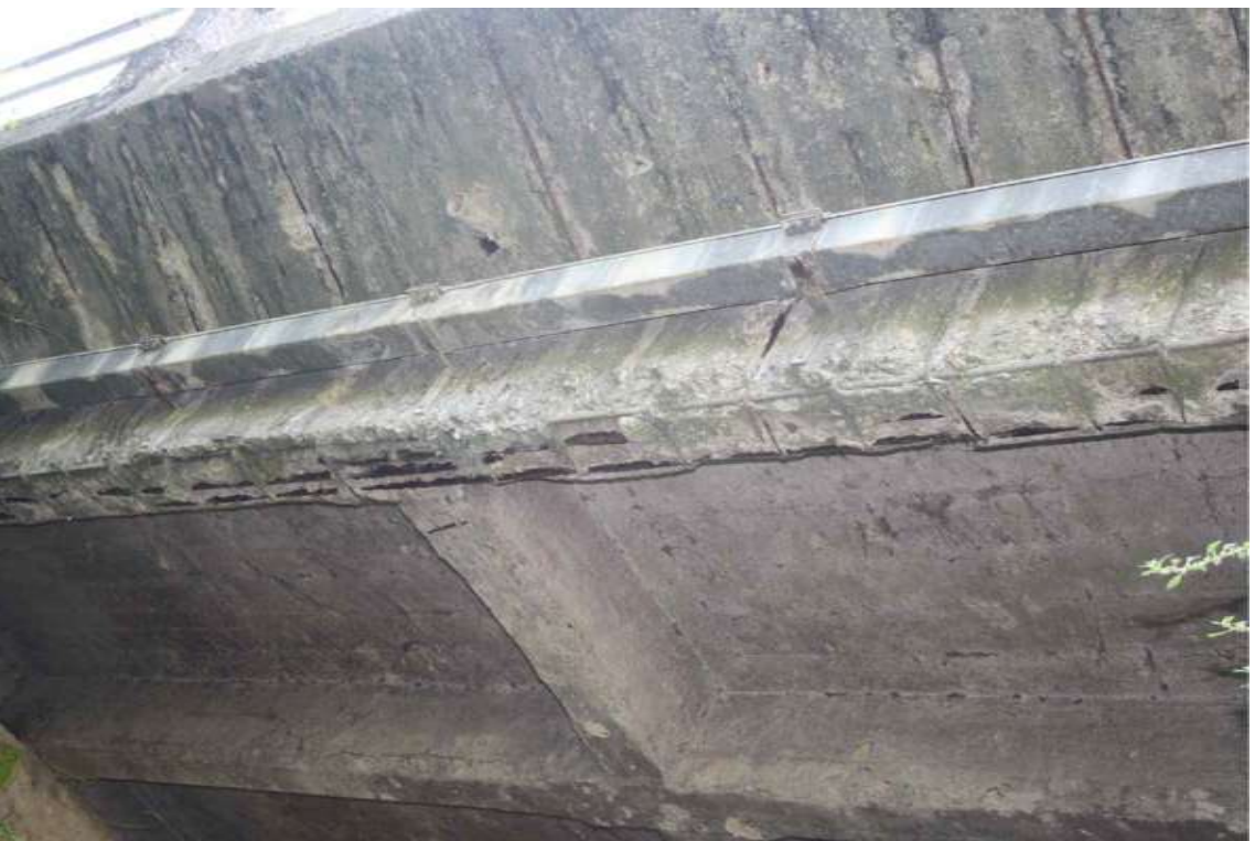
FOTO 14 - Impalcato lato monte - Particolare degrado
