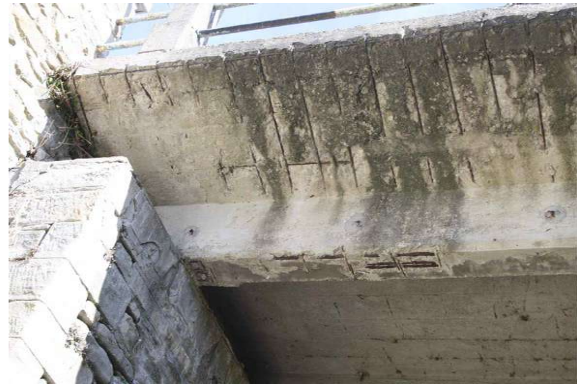
FOTO 15 - Impalcato lato valle - Particolare degrado
