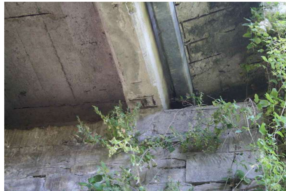
FOTO 11 - Impalcato lato monte - Particolare degrado
