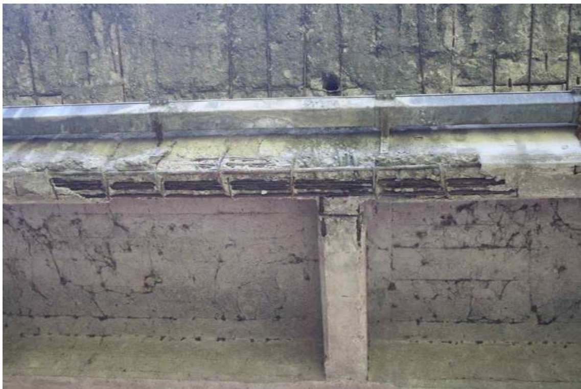
FOTO 12 - Impalcato lato monte - Particolare degrado
