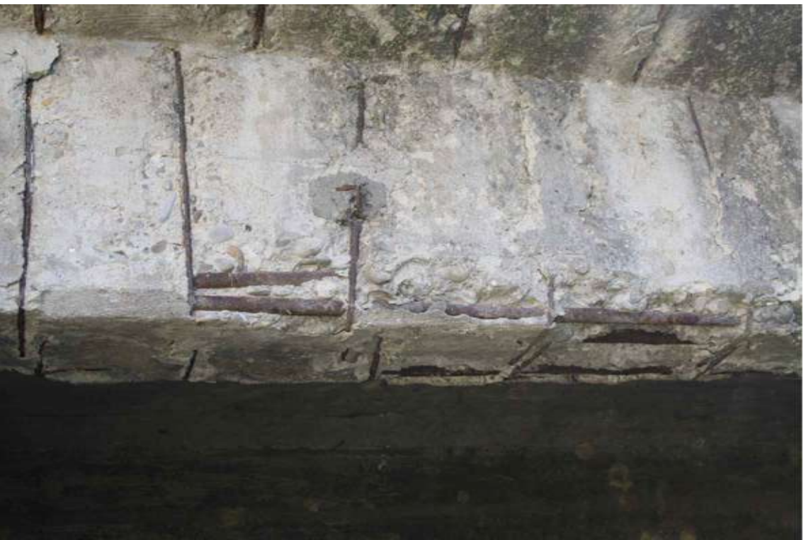
FOTO 18 - Impalcato lato valle - Particolare degrado
