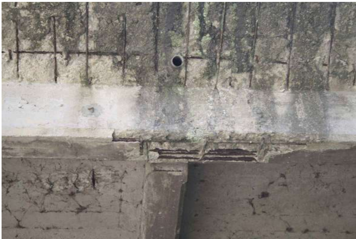
FOTO 16 - Impalcato lato valle - Particolare degrado
