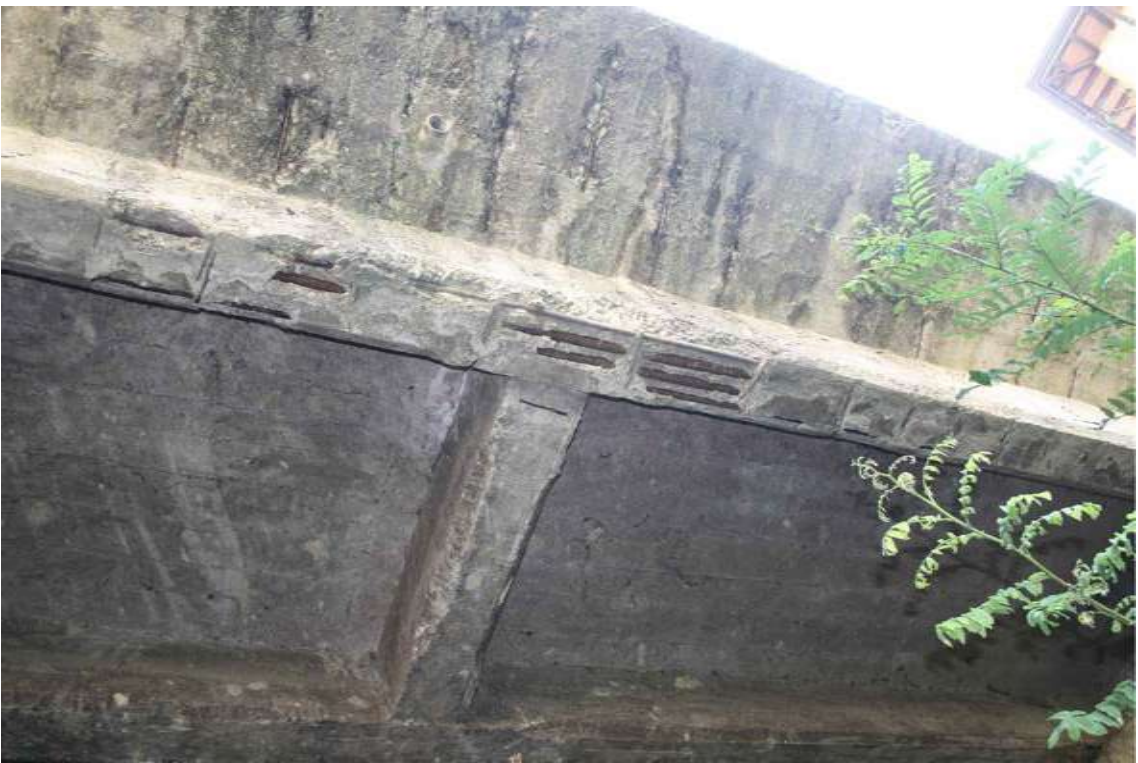
FOTO 17 - Impalcato lato valle - Particolare degrado
