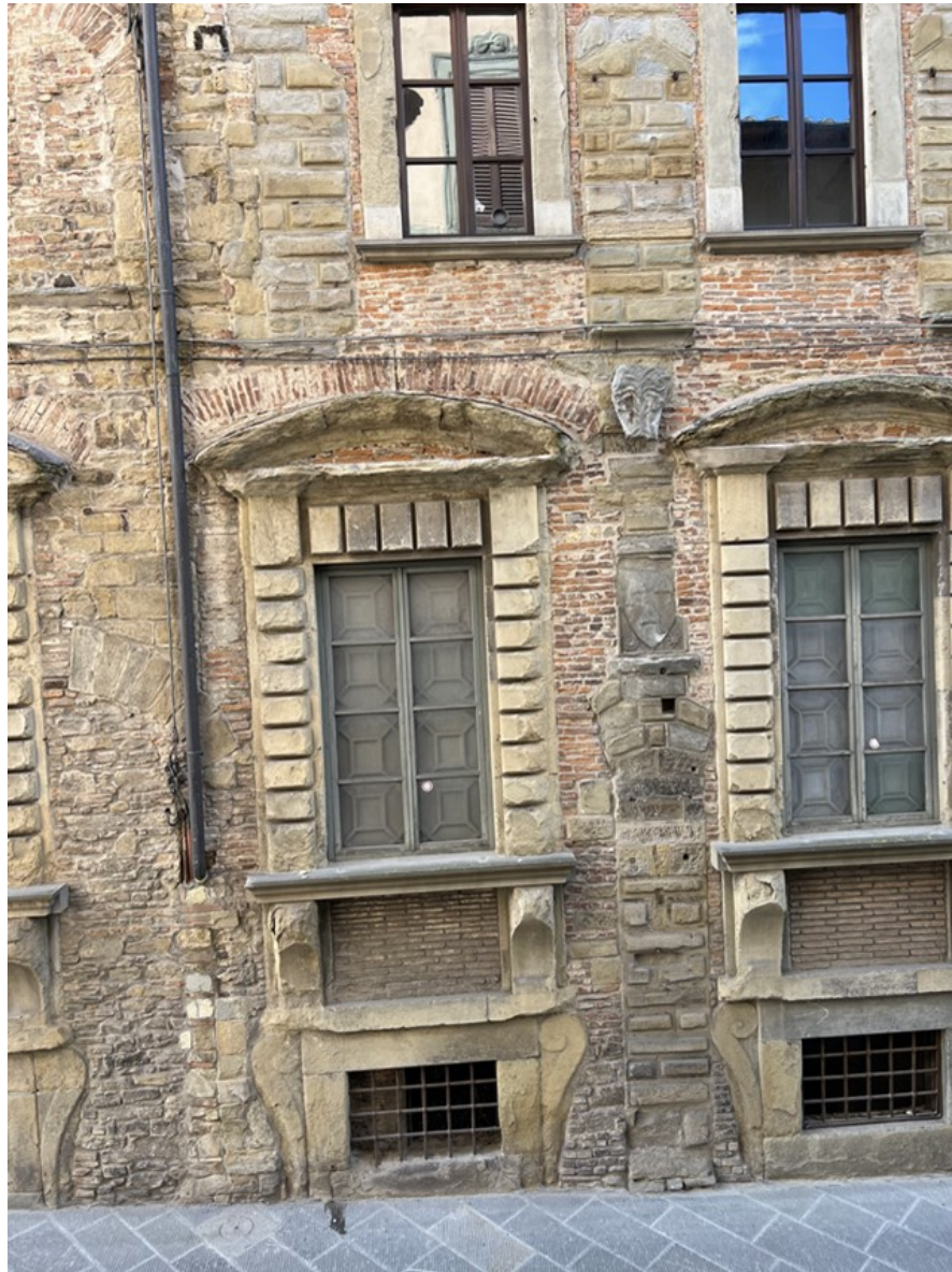
Vista delle edicole degradate su Via Ricasoli
