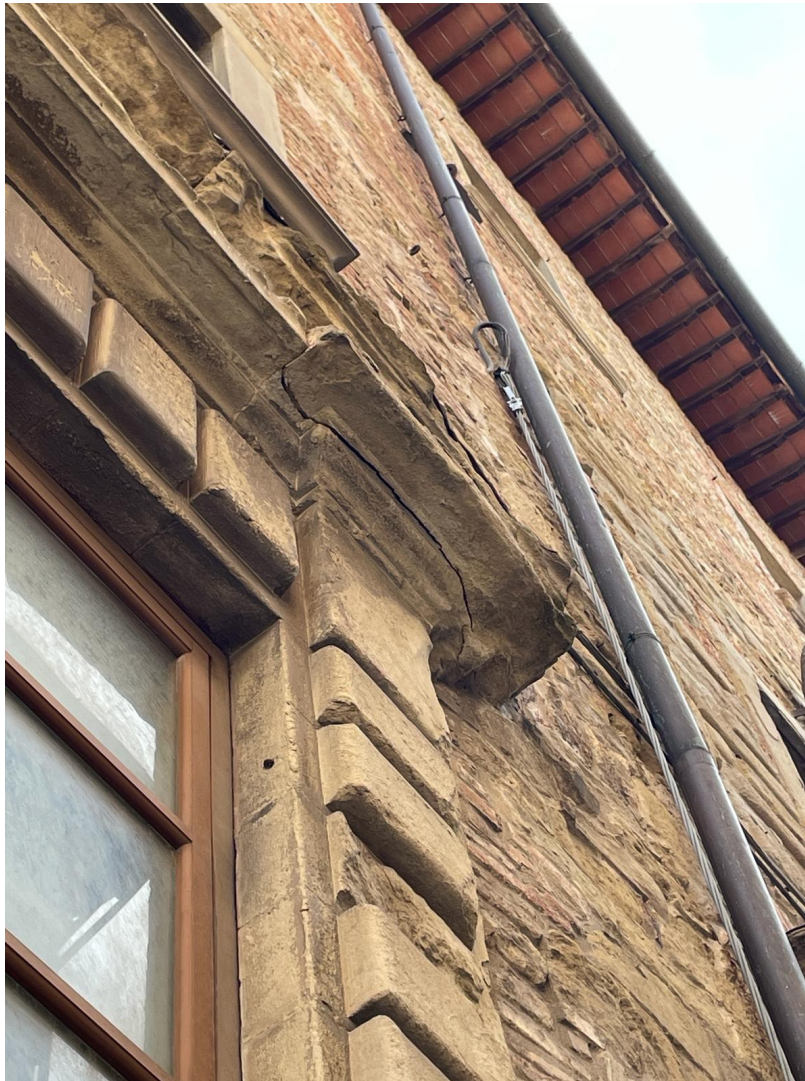
Dettaglio del distacco di una delle cornici dell'edicola
